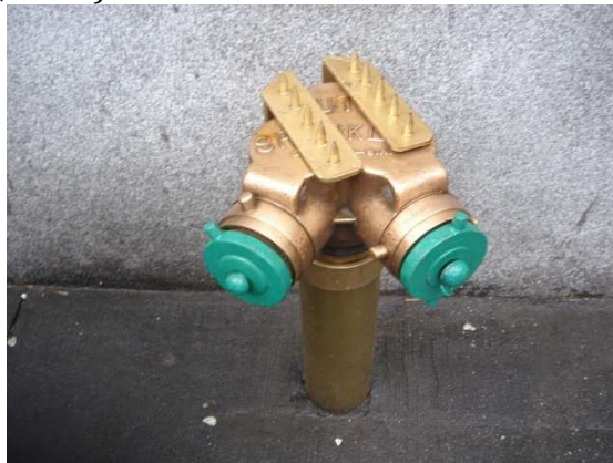
Boca de incendios con pequeños tacos de metal. Nueva York. Fuente: Nils Norman
